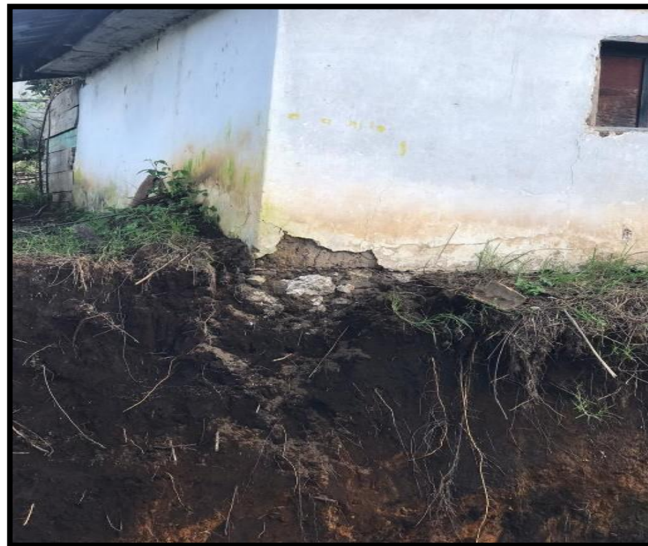
Ilustración 2 Casa en riesgo de aldea la Pista, Nebaj
