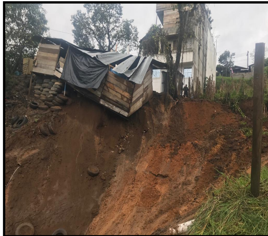
Ilustración 21 Casa en riesgo en cantón simocol Nebaj
